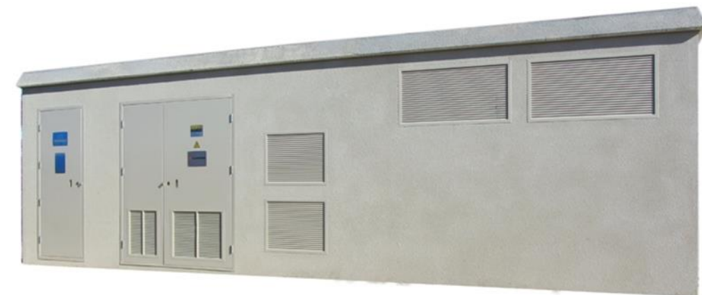
Figure 12 : Exemple d'un poste de livraison
